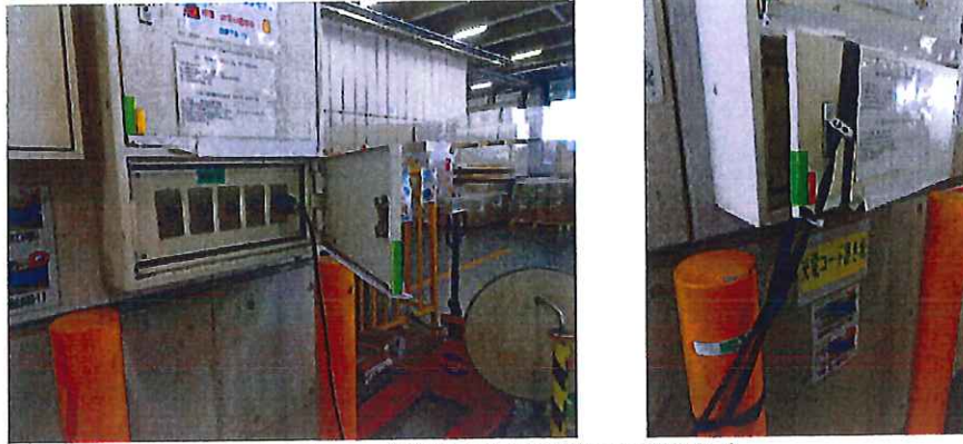
フォークリフト充電用の電源扉
